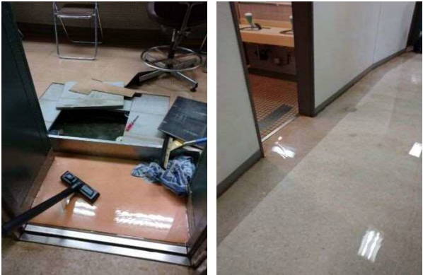
【諸室湧き水】 床下から漏水
