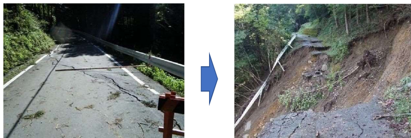
写真 路面の段差・開口亀裂等から崩壊へ進展
