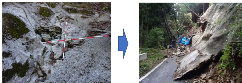
写真 吹付け表面の亀裂・剥離等の変状から崩壊へ進展
