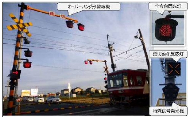
【安全対策助成事業】 踏切保安設備の更新
