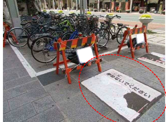
図 43- 駐車場の注意喚起標識の劣化状況
