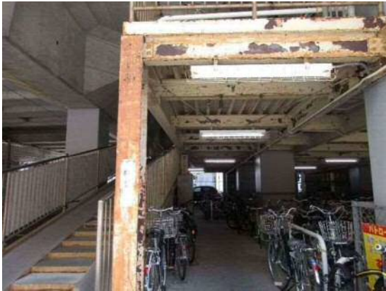
図 42- 駐車場施設の塗装の劣化状況
