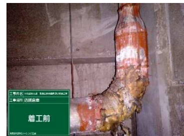
老朽化した設備系統
