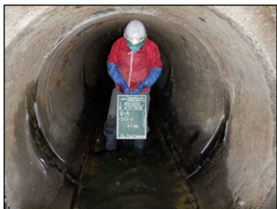
<改築前>老朽化した管路
