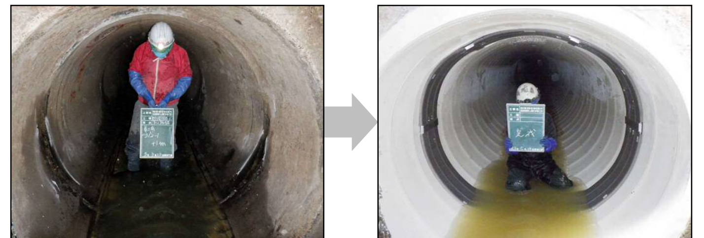
<改築前>老朽化した管路
