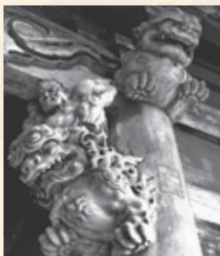
▲修理前の「力人」「獅子」「虎」4本の柱それぞれに取り付けられている
