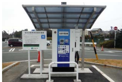
急速充電器(舘山寺公共駐車場)
