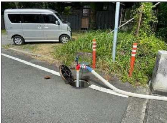
熱海側排泥口
