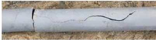
▲劣化により裂けてしまった水道管
