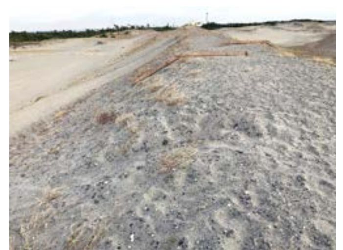
防潮堤の上部の浸食部分
