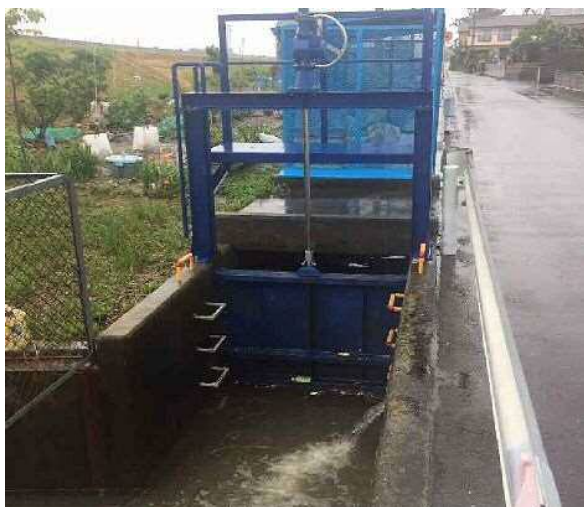
下江用排水路鋼製ゲート
