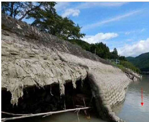
配艇場の損傷の様子
