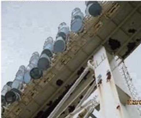
【照明台腐食・剥離】
