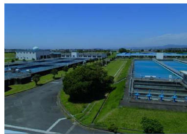
大原浄水場浄水施設
