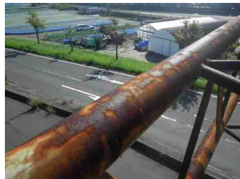
写真 3-2 区分Ⅱの損傷例 （横梁の腐食）
