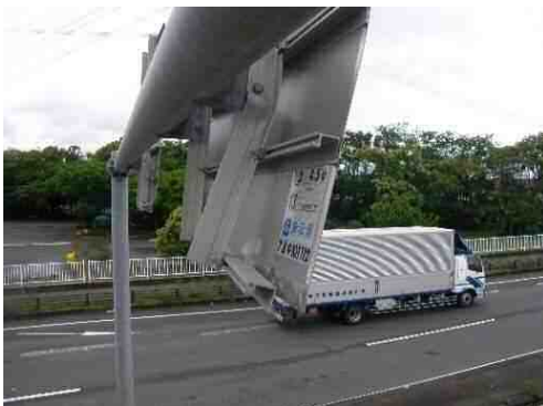
写真 3-1 区分Ⅲの損傷例 （標識板の変形）
