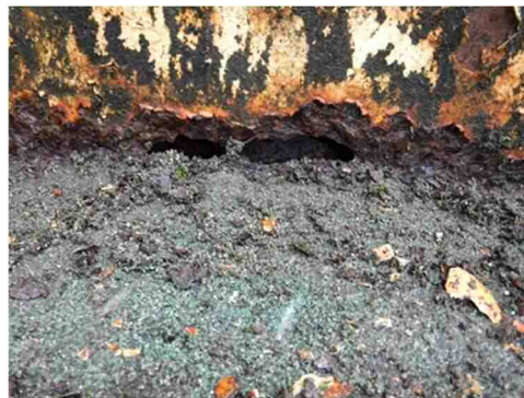
写真 3-2 区分Ⅱの損傷例 （地覆の腐食（孔食））
