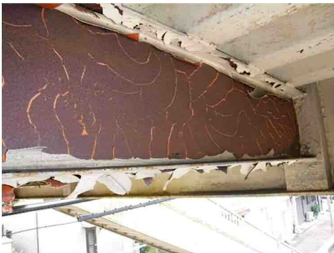
写真 3-1 区分Ⅱの損傷例 （横桁の腐食）
