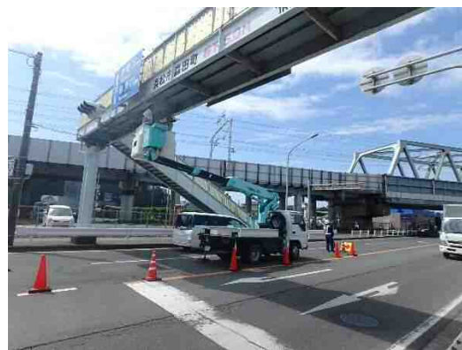
写真 4-2 高所作業車による近接目視点検
