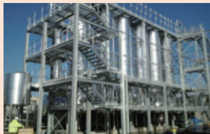
【汚泥可溶化設備】
