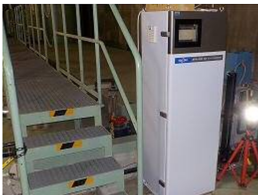
放流水自動測定機器の確認
