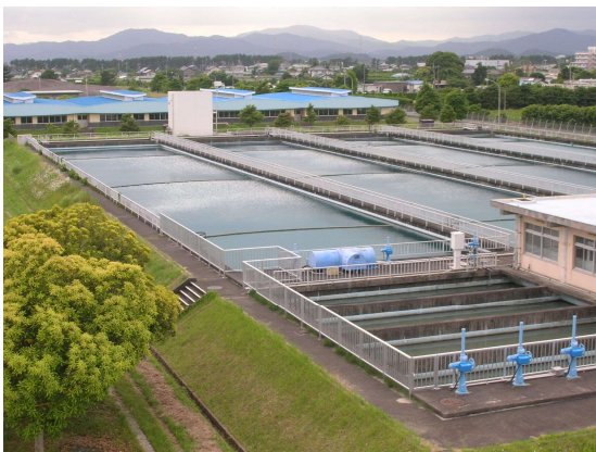
[参考] 浄水施設（沈澱池）
