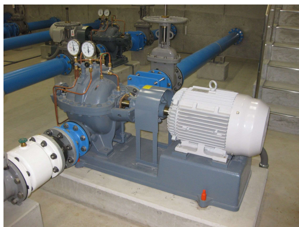
[参考] ポンプ設備
