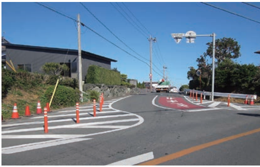
交通安全対策の施工例 (ラバーポールの設置と区画線の引き直し)
