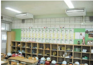
教室に設置された空調機器（三方原小学校）
