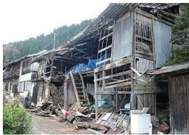
倒壊のおそれのある空き家のイメージ(出典:「空き家の現状と課題」(国土交通省))
