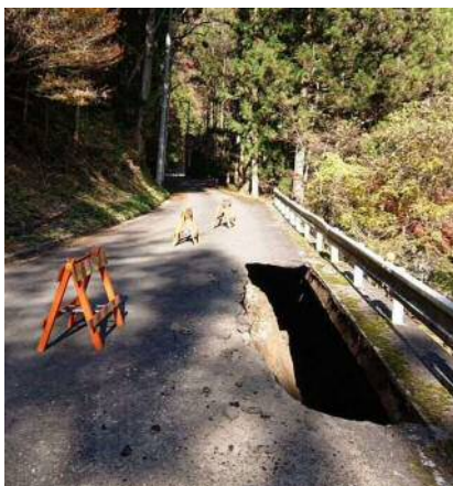
林道白倉山線陥没現場
