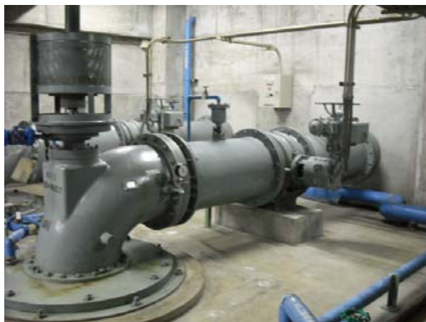
ポンプ場内部の様子
