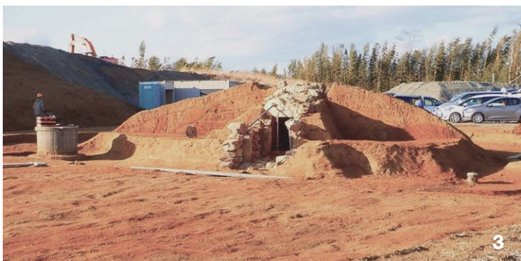
3：墳丘盛土除去後の墳丘 土層観察用ベルトを残して古墳時代の地表面まで掘削。石室が確認された。
