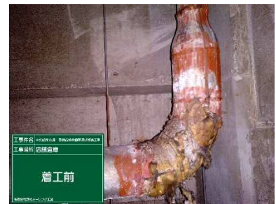
老朽化した設備系統
