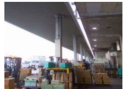
買荷保管積込所と卸売場底との間の隙間
