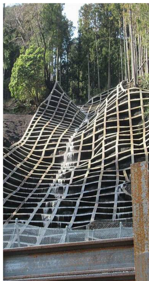
国道 152 秋葉トンネル北口付近 昨年 6 月の斜面崩壊を復旧工事中。 2 月 20 日午前 復旧斜面を大水が 滝のように流れた。 上は林道高平線。
