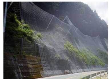
▲国道152号道路防災の状況
