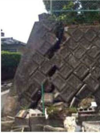
L 3 間知ブロック積擁壁の著しい変状
