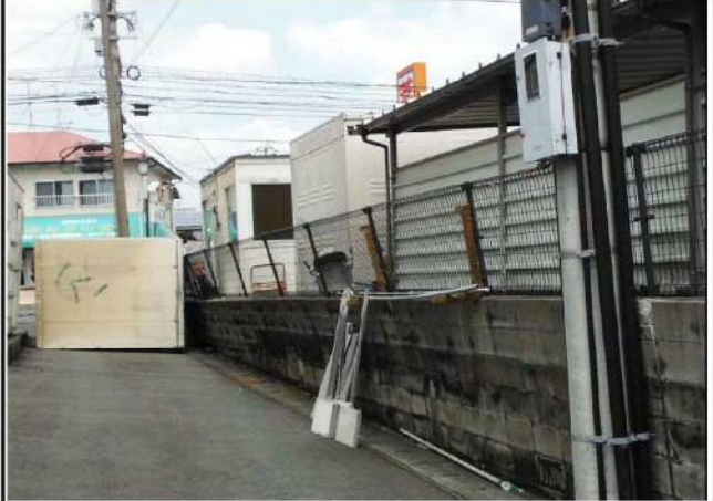
L 3 空洞コンクリートブロック積擁壁の著しい傾斜
