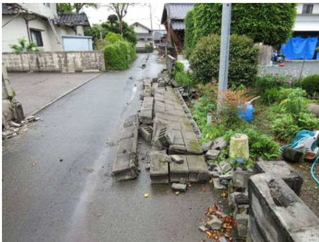
平成28年熊本地震による ブロック塀の倒壊
