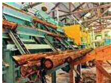
【木質ペレット製造施設】
