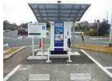
【電気自動車用急速充電器】
