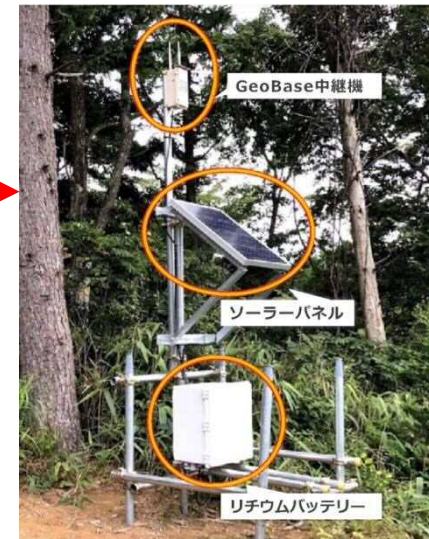
中継機(ソーラーバッテリー)で稼働
